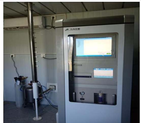
图 4.2-24 废气在线检测设备
