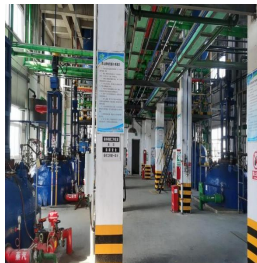
3.4-8 四车间 DPE 生产线
