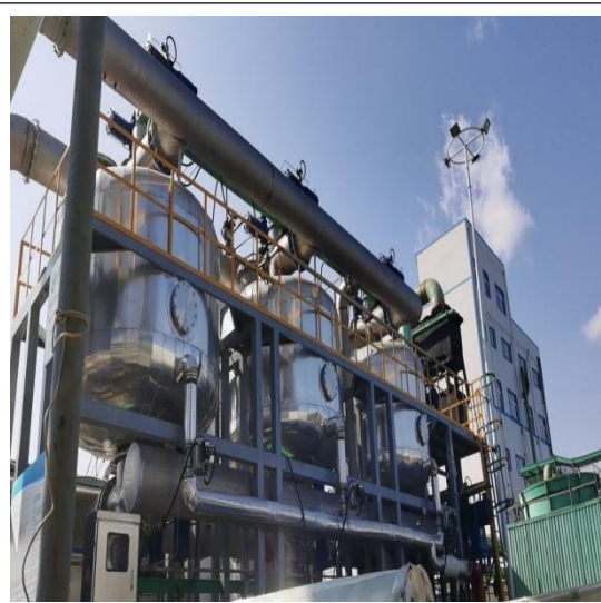
图 4.1-10 管活性炭吸附再生装置
