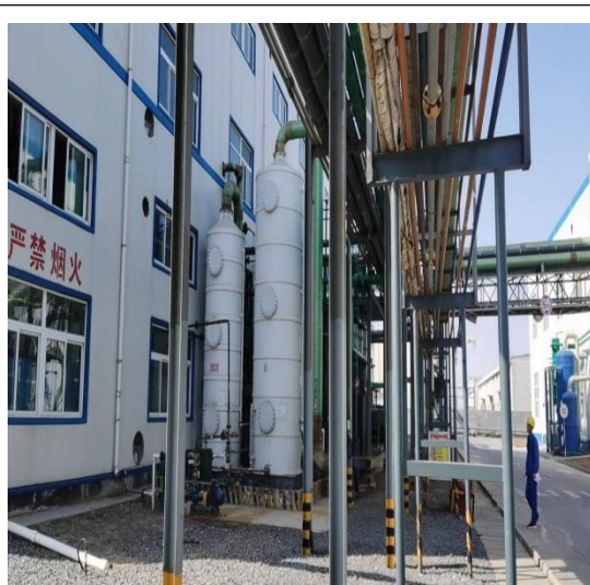
图 4.1-8 四车间除尘器
