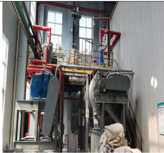
图 4.1-6 二车间旋风+布袋除尘器
