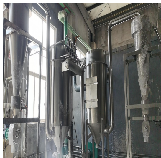
图 4.1-3 一车间旋风除尘器
