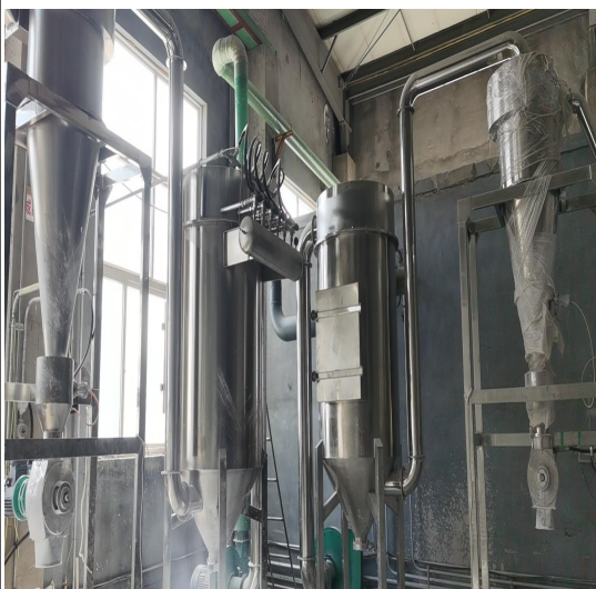
图 4.1-2 一车间除尘器
