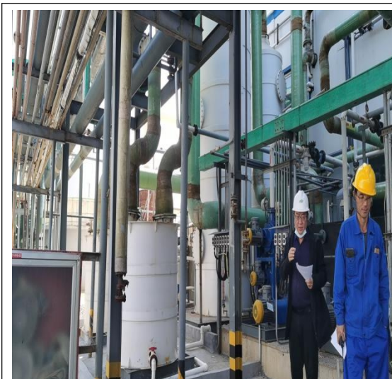
图 4.1-7 三车间水冷凝
